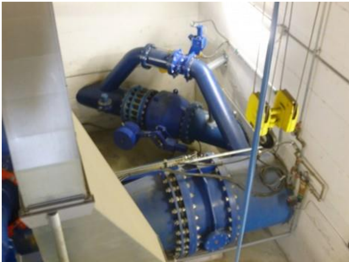
Foto 10: valvola di scarico e by-pass aggiuntivo
